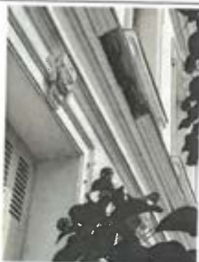
Parement dégradé de la corniche (pignon droit)
